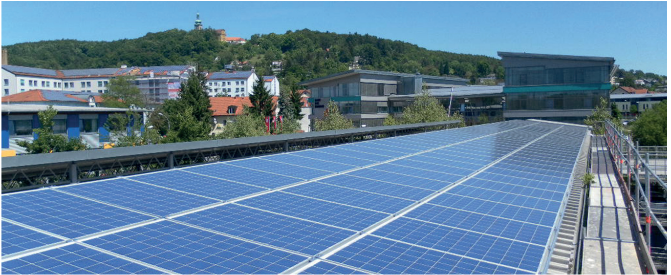
Amberg, Bayern 452 kWp
