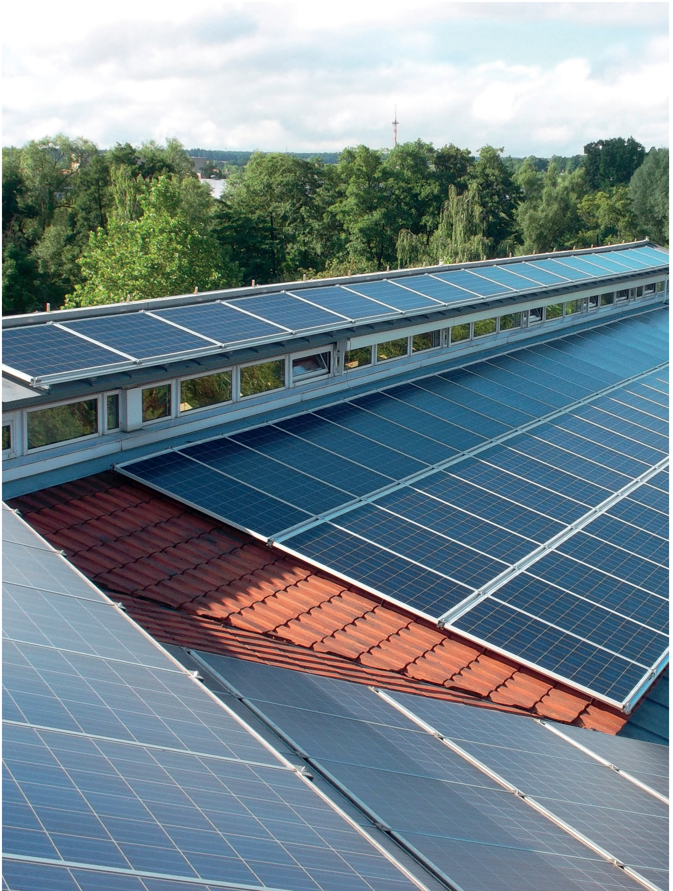
PV-Anlage Stadtwerke Amberg
